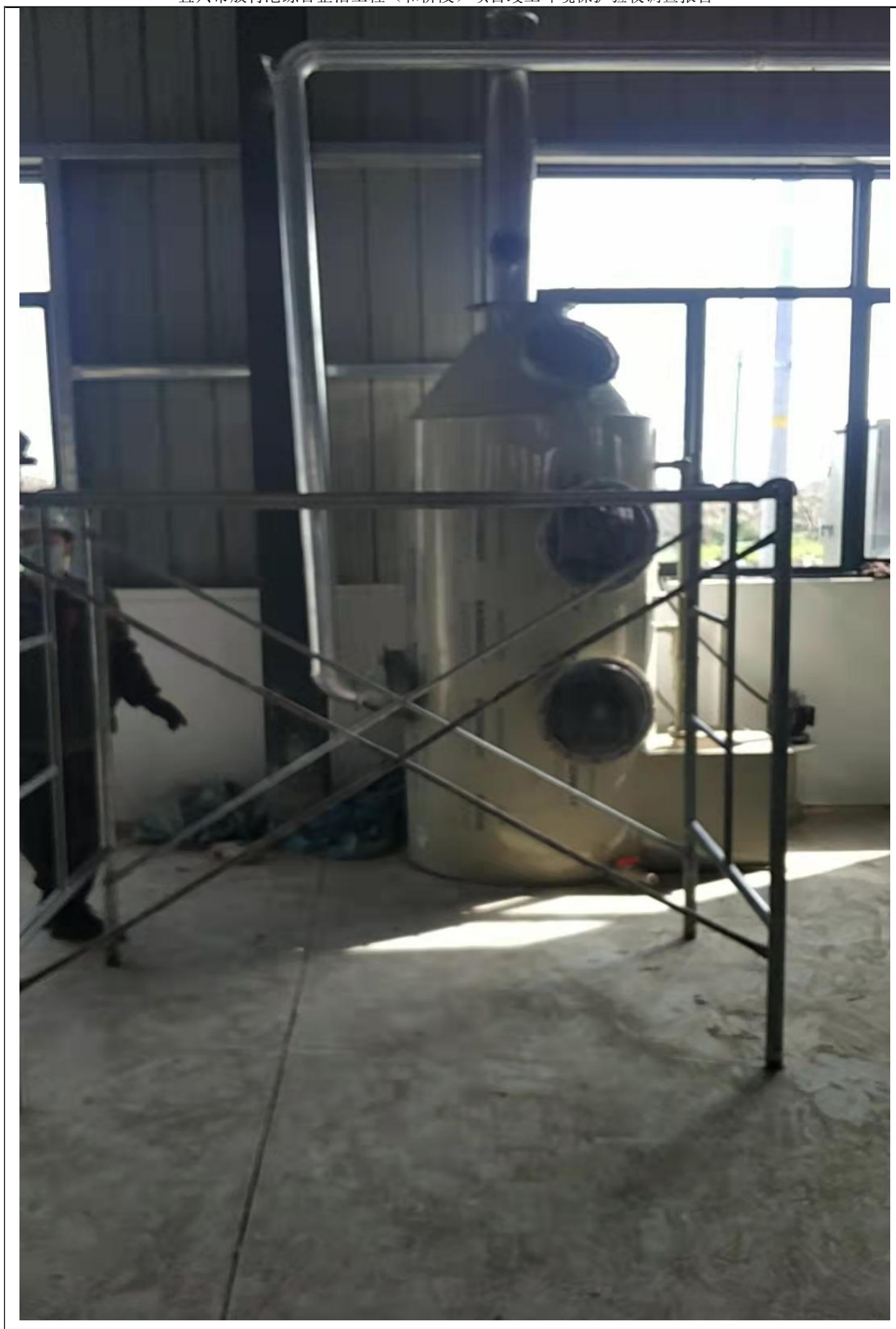
图6.2-1 废气处理装置
